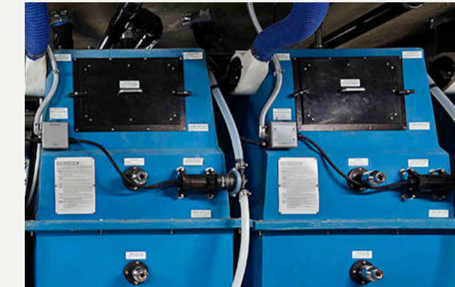
COMPOSTEIRAS. FONTE: BULLITT FOUNDATION, 2020
